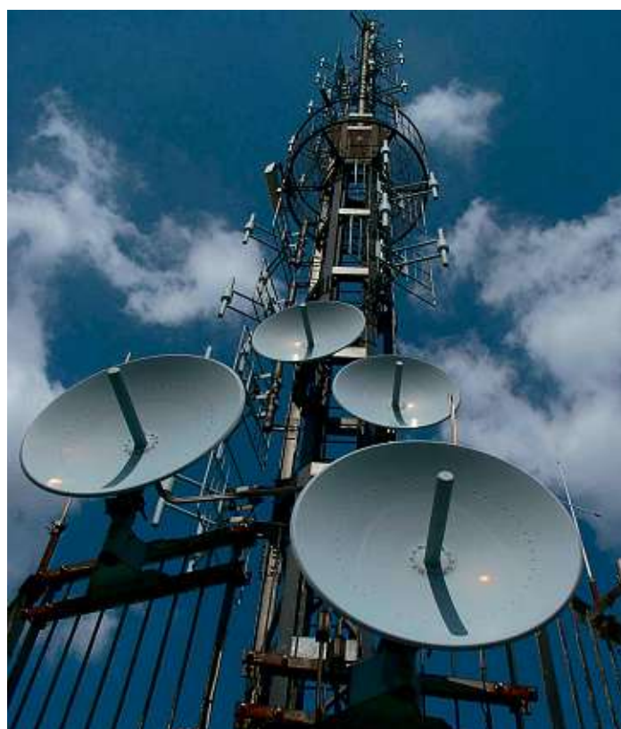
Antennenträger mit AIS-Antennen
