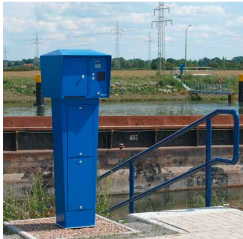
Stromtankstelle mit RFID
