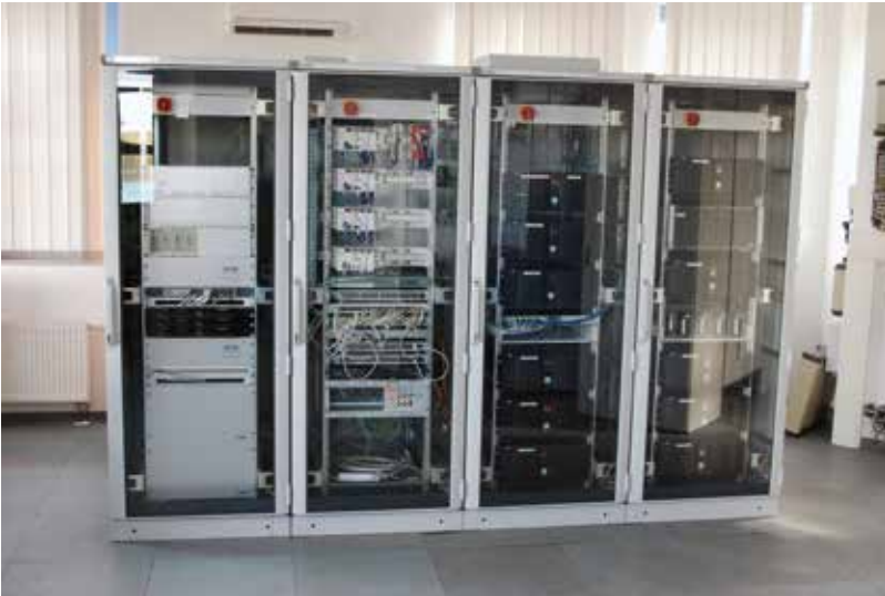
Ein Technikschränk der Leitzentrale Rothensee
